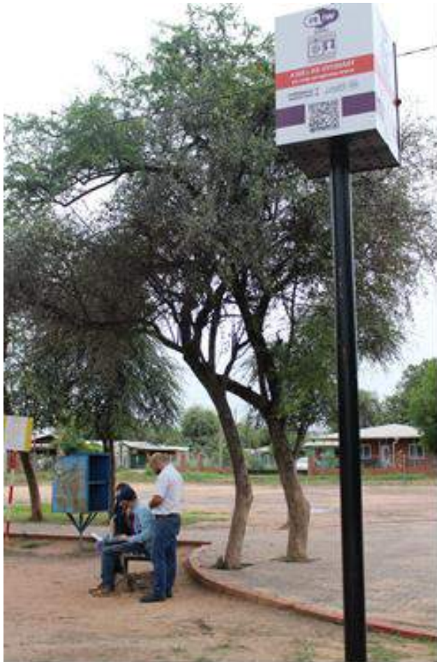
Fotografía Nº 1: Equipo instalado y funcionando en Plaza San Miguel, Loma Plata.
