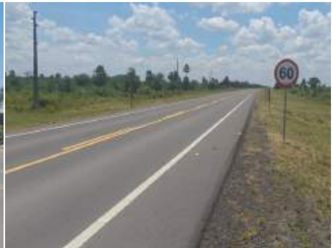
Fotografía 2: Estado actual del pavimento
