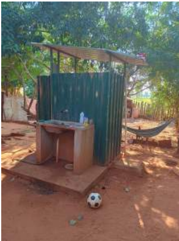
Fotografía N° 1: Unidades Sanitarias Básicas.
