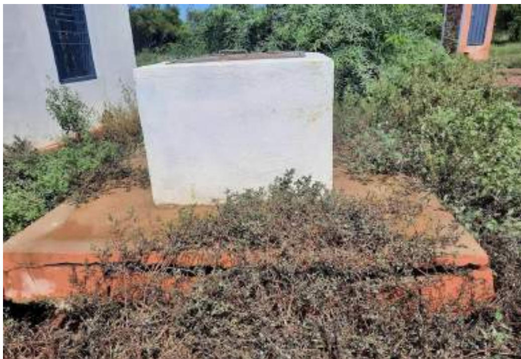
Fotografía N° 5: Aljibe con rotura de zócalo exterior.
