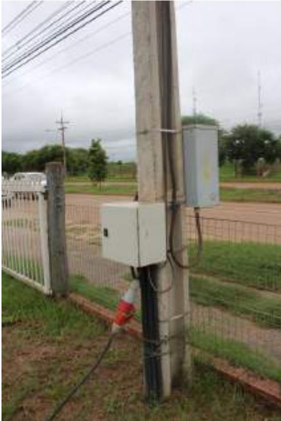
Fotografía N° 9: Parte del Equipo instalado dentro del Parque.
