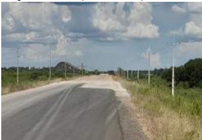
Fotografía 3: Estado actual del camino de acceso al puente Nanawa.
