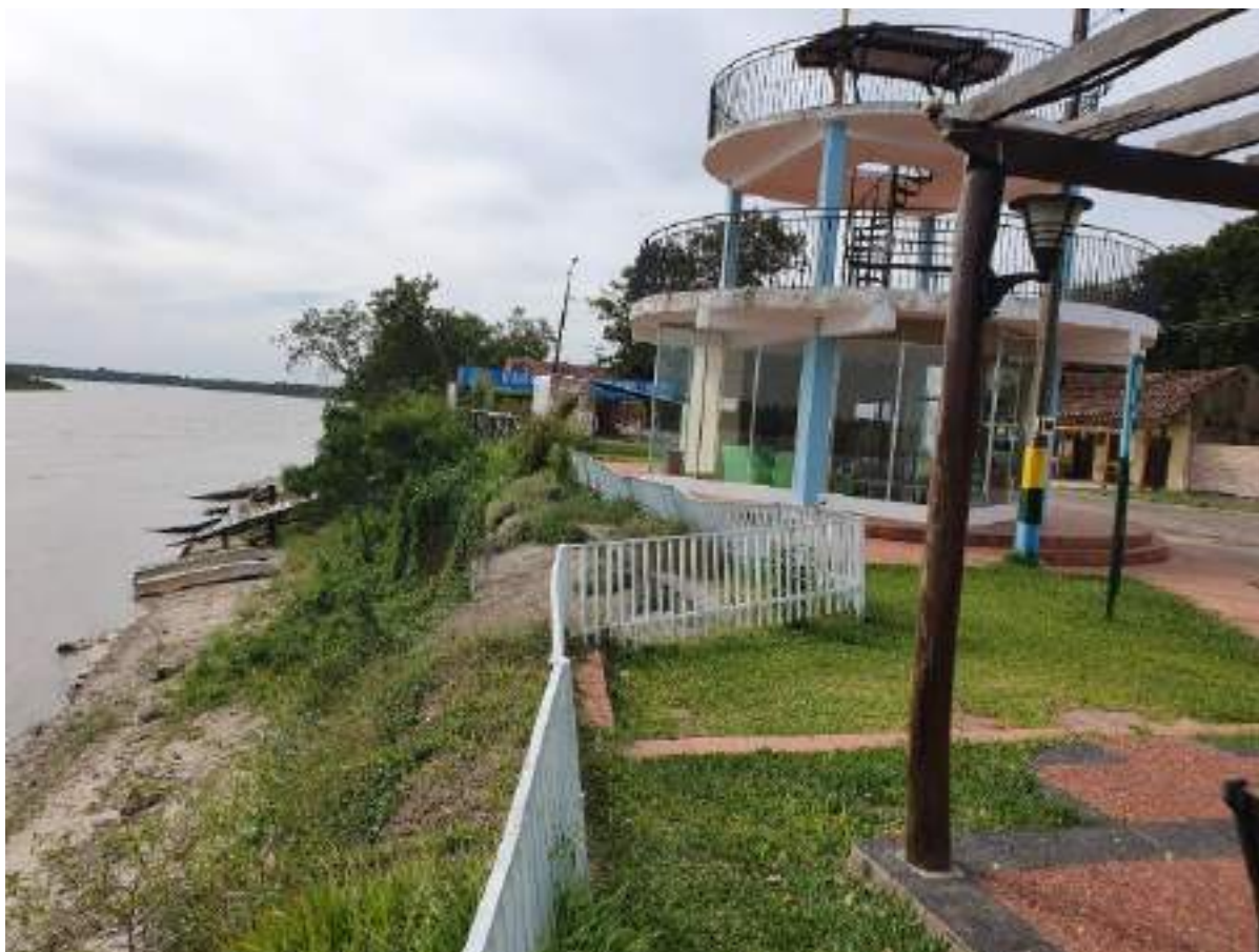
Fotografía N° 8: Estado del área del mirador antes de las obras de mejoramiento realizado en el marco del Proyecto
