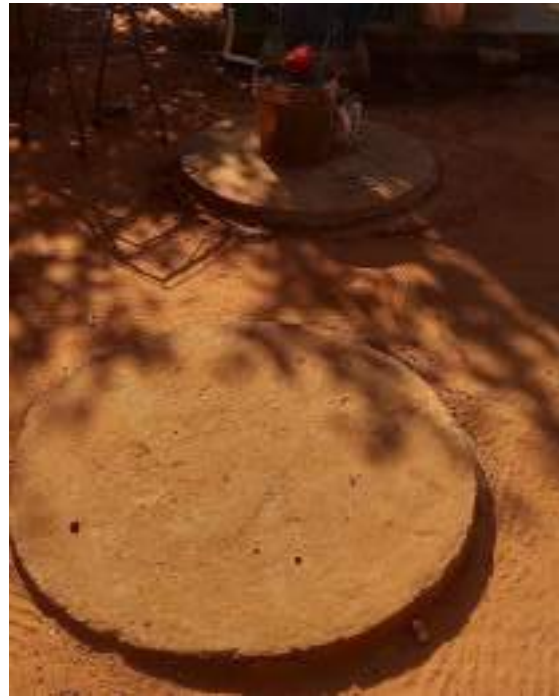
Fotografía N° 4: Cámara séptica prefabricado de hormigón armado sellada.
