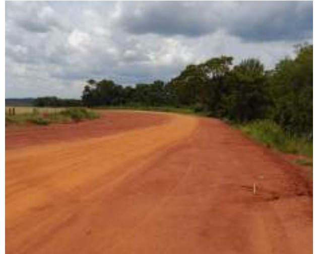
Fotografía N° 10: Otra vista del estado de un sector del tramo del lote 2
