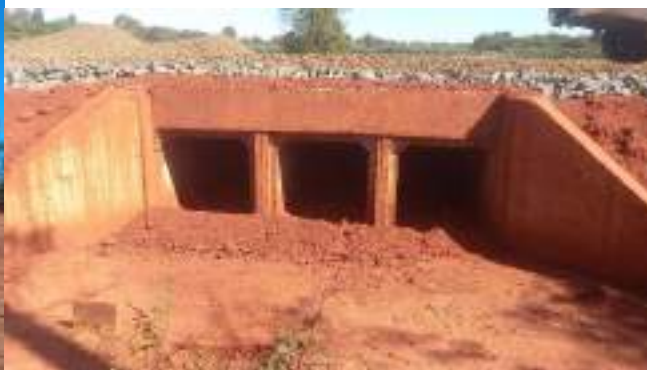
Fotografía N° 14: Aliviadero triple de 2 x 2 mts. en el Arroyo La Familia
