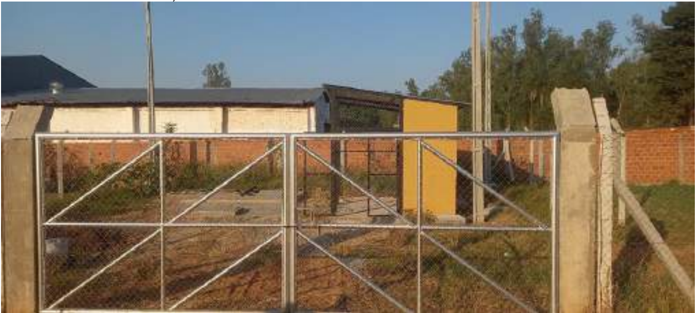
Fotografía N° 12: Estación de Bombeo de 15 hp con transformador de media tensión
