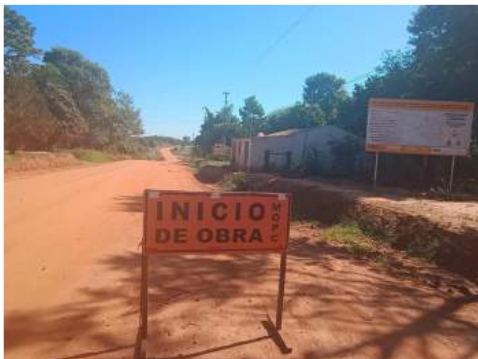
Fotografía N° 1: Cruce de San Isidro del distrito de Luz Bella, donde inició el monitoreo. Actualmente camino de tierra, en proceso de terraplenado.
