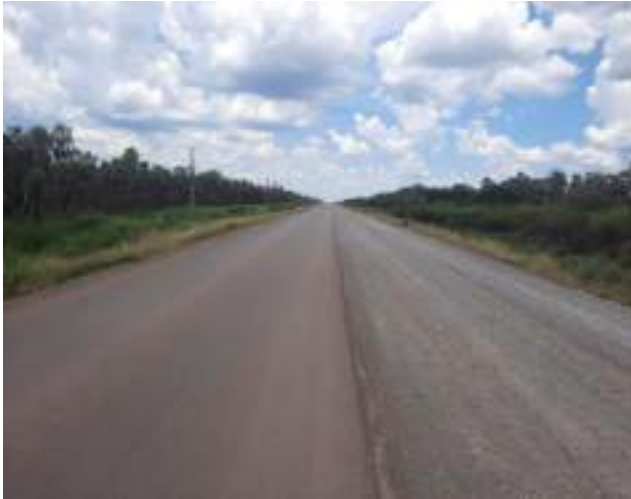
Fotografía 5: Asfaltado con capa inferior a la capa rodadura
