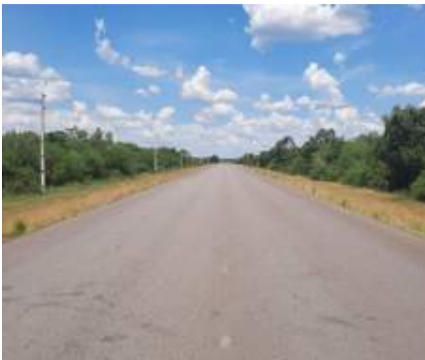
Fotografía 1: Estado de pavimentación de parte del lote 3
