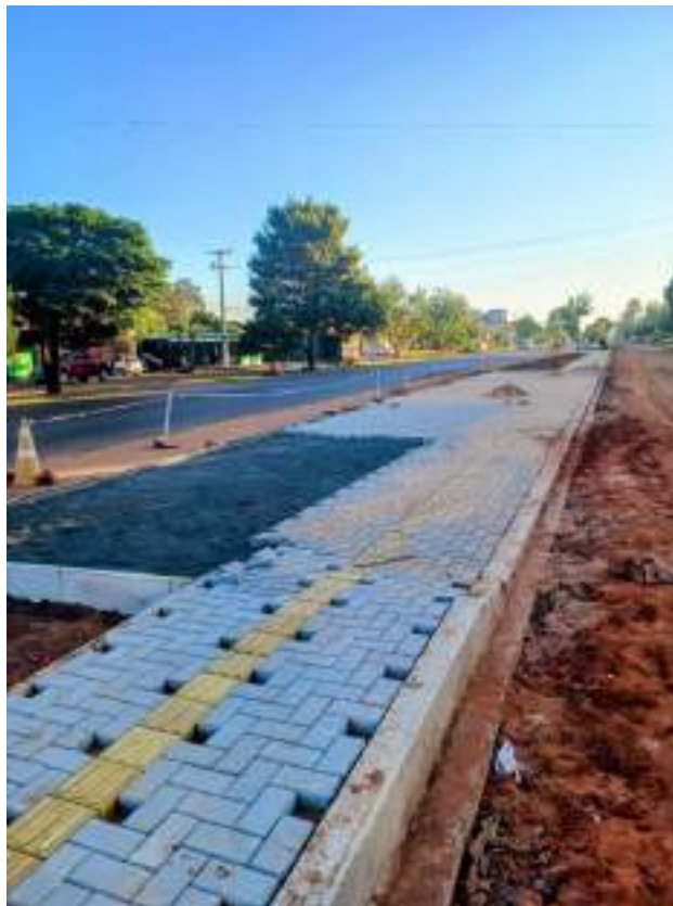
Fotografía N° 6: Construcción de caminos para el peatón en ejecución, sobre la ruta D006.
