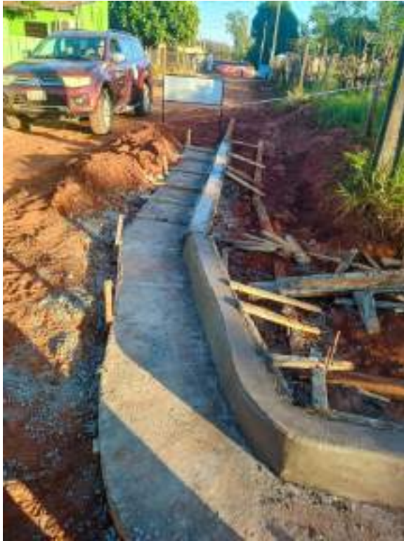
Fotografía N° 8: Construcción de caminos seguro para escolares, desde la Ruta D006 hasta la escuela.
