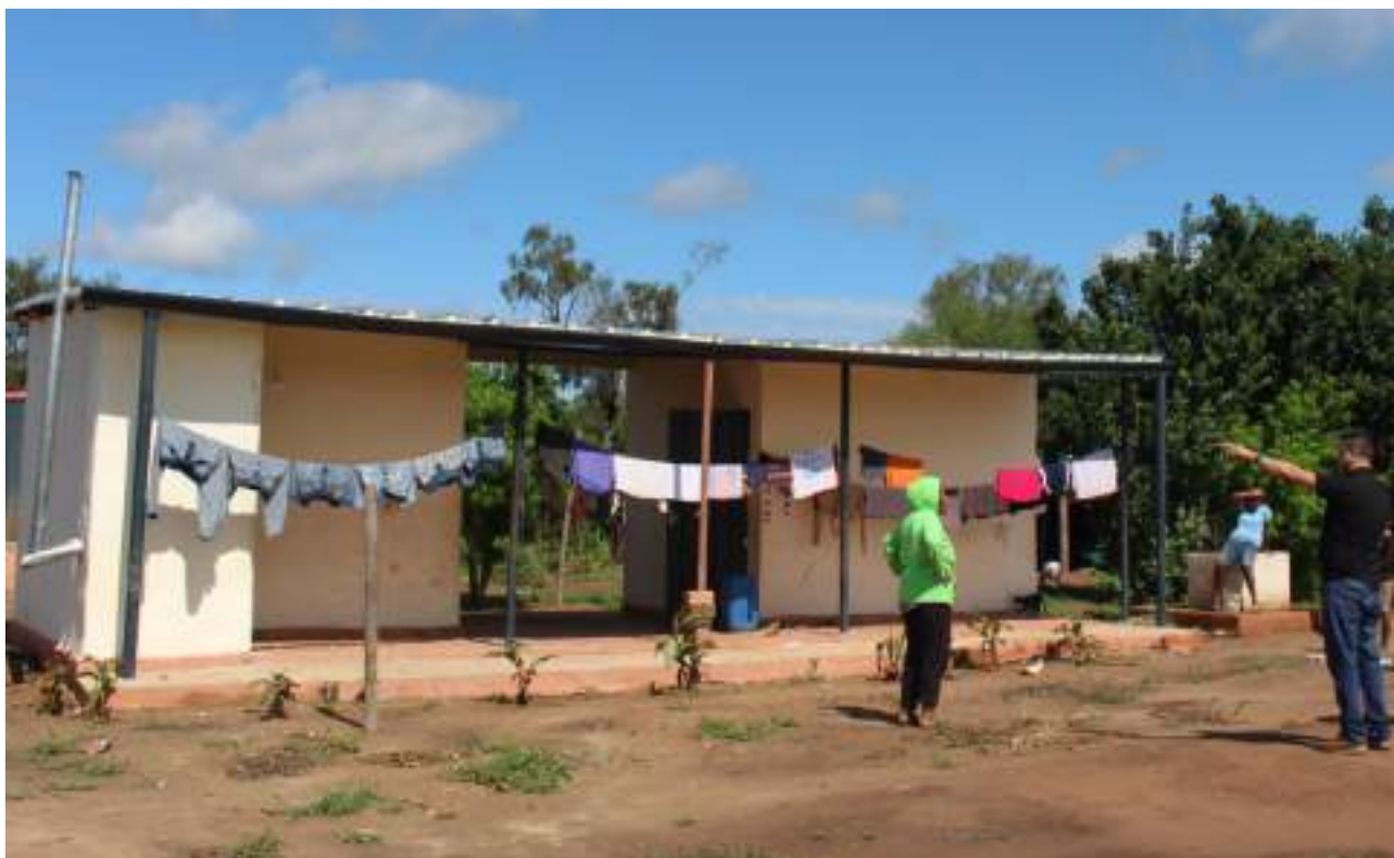
Fotografía N° 3: Vivienda construida – Canaleta de desagote frontal con deformaciones.
