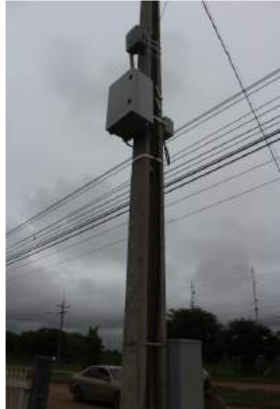
Fotografía N° 10: Parte del Equipo instalado dentro del Parque.
