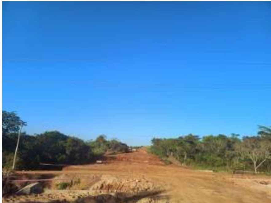
Fotografía N° 4: Línea de alta tensión de la ANDE quedó muy bajo con la intervención del terraplenado.
