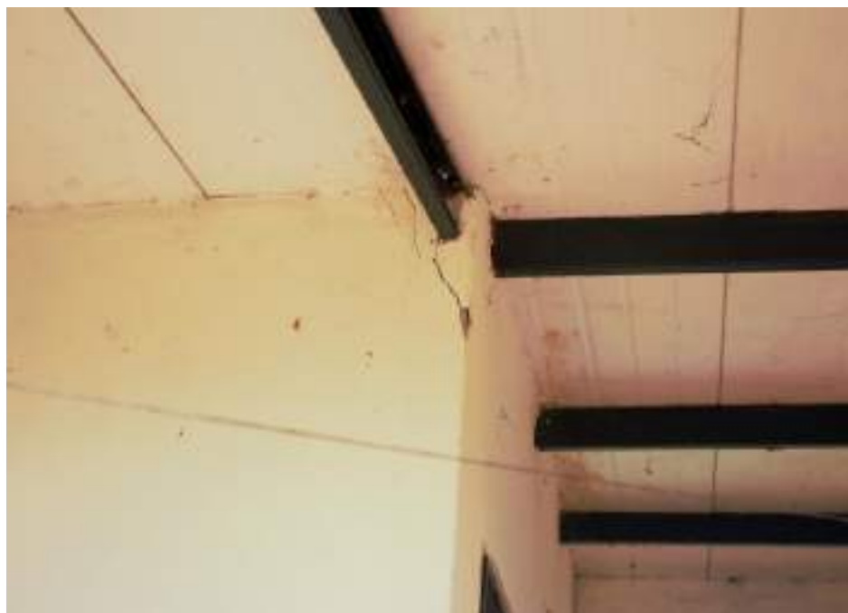
Fotografía N° 4: Mampostería de vivienda con fisuras de relevancia.
