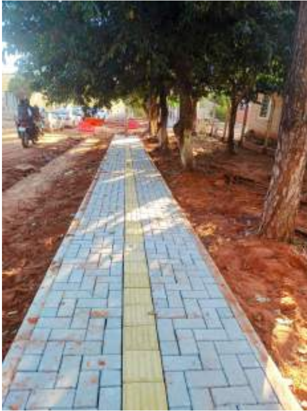
Fotografía N° 12: En ejecución la construcción de camino seguro alrededor de la segunda escuela en Capiibary.
