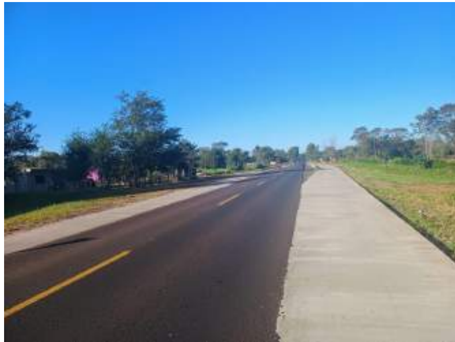
Fotografía N° 14: Estación de Pesaje para camiones, llegando al Centro Forestal Capiibary.
