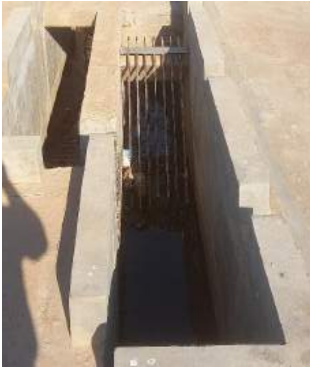
Fotografía N° 6: Estructura para el Filtro del pre tratamiento de aguas residuales
