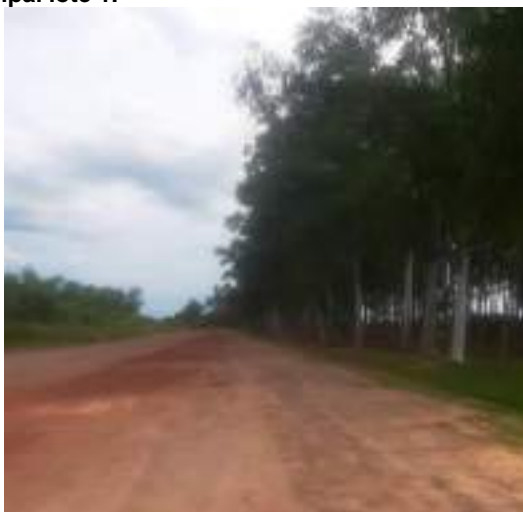
Fotografía N° 19: Estado actual del camino de Acceso al Puerto Mbopicua
